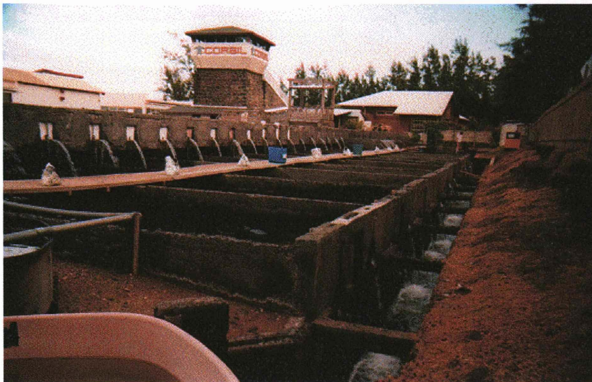
Photo 5 : bassin de 40 m 3
