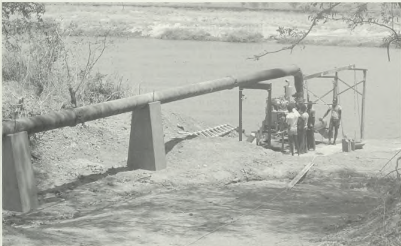
Station de pompage provisoire pour pivot (Sonasut). (© Cirad)
