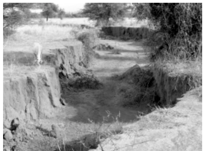
Figure 11 : effets de l'érosion hydrique (entre Linguère et Labgar).
