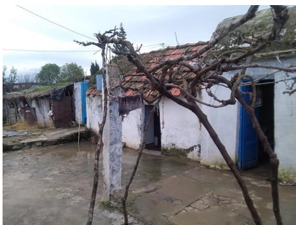
Figure 5 - Une maison dans le "refuge" de Zabbous. Construites par l'Etat, elles sont aujourd'hui en très mauvais état. Photo issue du travail de diagnostic du programme PACTE, 2019
