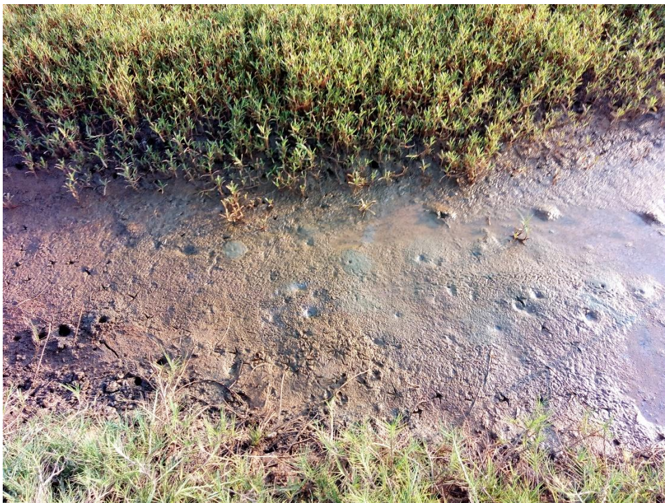
Exemple d'envasement des bords de casiers demandant un travail de curage (janvier 2022)
