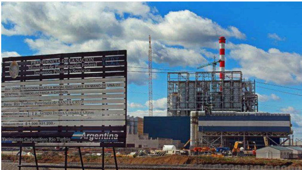
Figura 7.4. Central Termoelectrica a Carbón. El Espejo Diario (s.f.), recuperado de elespejodiario.com/presentan-accion-de-amparo-por-la-termoelectrica-a-carbon-de-rio-turbio/ [consultado 14/06/2019].
