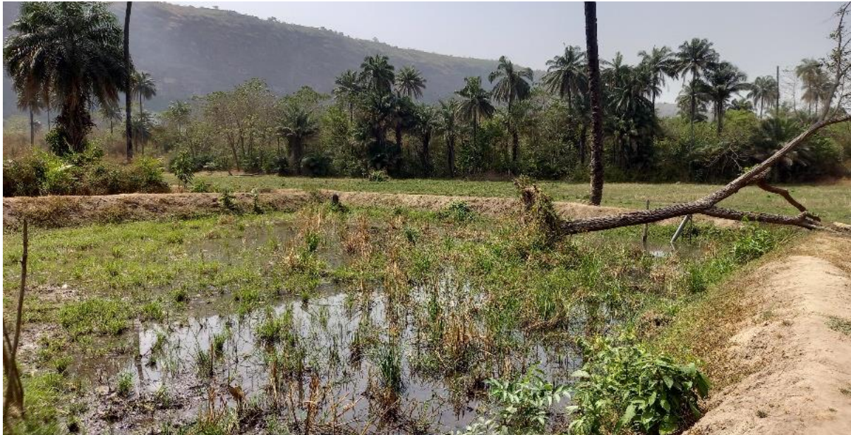
Etang en dérivation ouvert à Dentagaya, fuite de l'eau malgré le creusement d'une tranchée argileuse devant la digue.
