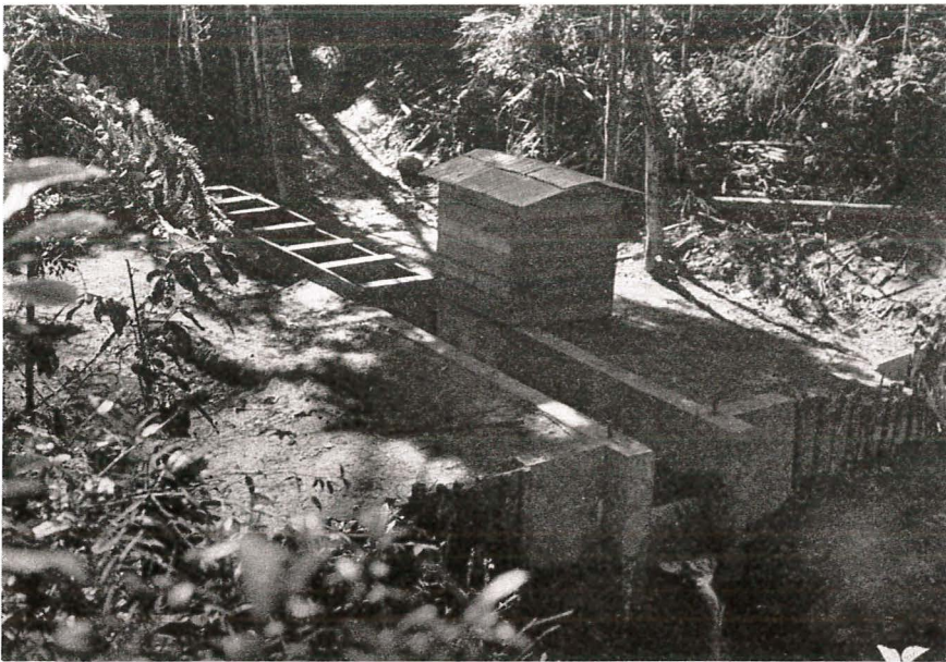
Grands bassins de Périnet. Ampangalatsary. Déversoir D3.
