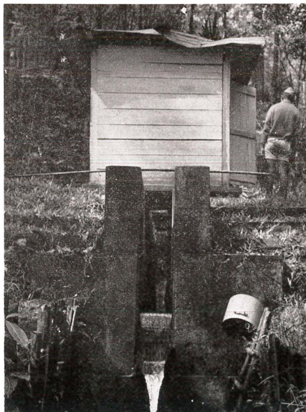
Grands bassins de Périnet. D5 après surélévation.
