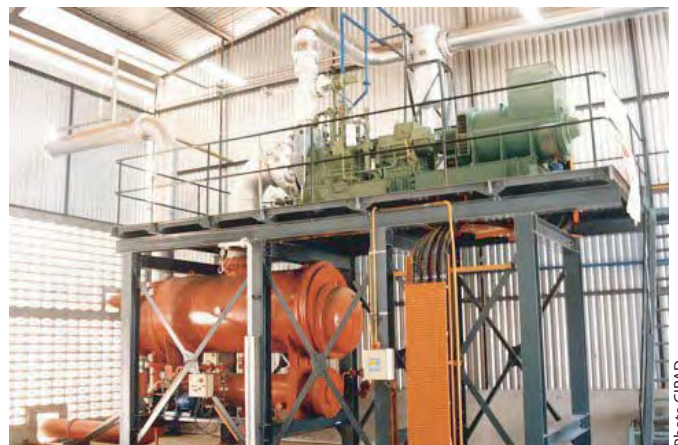
Turbine à vapeur de 900 kW dans une centrale de cogénération à bois.
