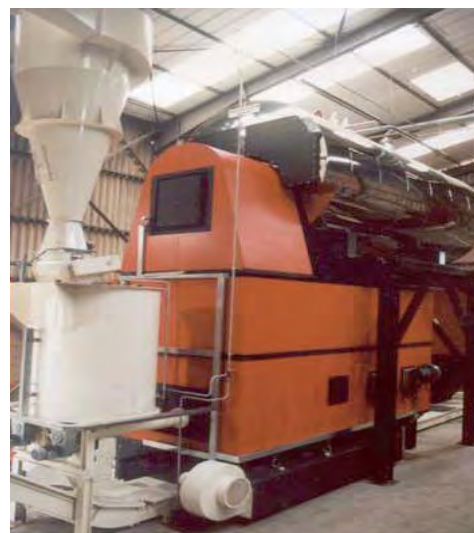
Chaudière à vapeur de 4 MW alimentée par déchets bois
