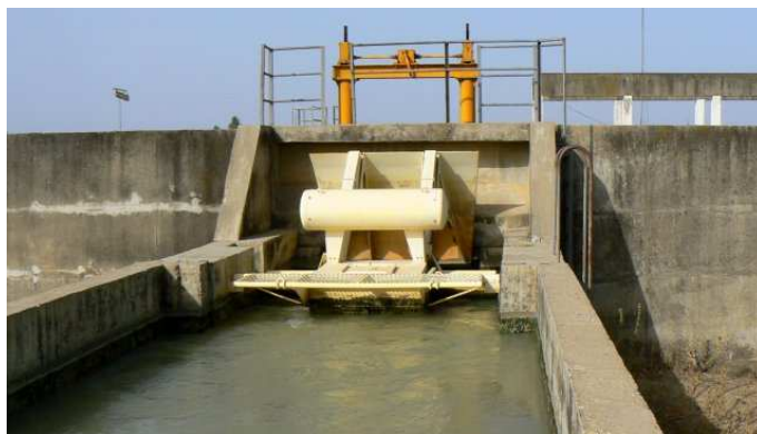
Photo 9 : Vanne de régulation du débit d'eau dans un canal
