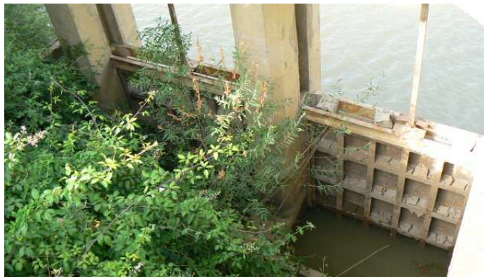
Photo 6 : Entrée des galeries de la station de pompage du S7B
