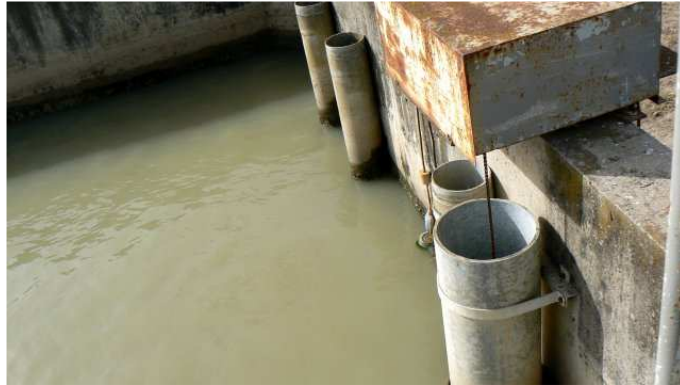
Photo 8 : Bassin de régulation et système de contrôle du niveau d'eau
