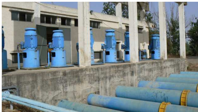
Photo 7 : Pompes de la station du secteur S7B
