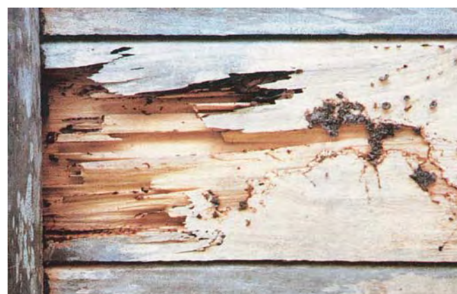
Dégâts causés par des Nasutitermès.
