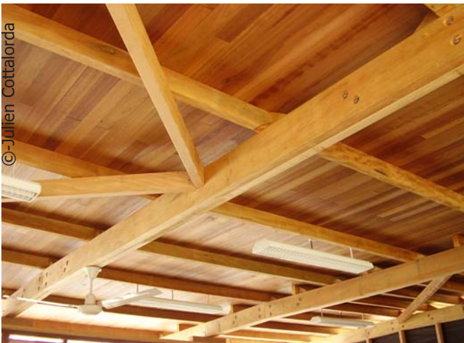
Sous toiture en matériau isolant (ici de l'Angélique) pour limiter les apports de chaleur dans la pièce.
