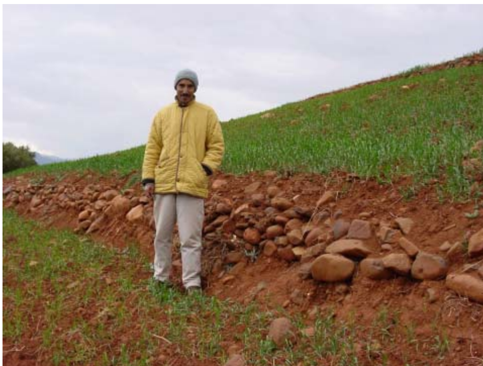
Figure 6. Murette non entretenue installée par un ancien projet
