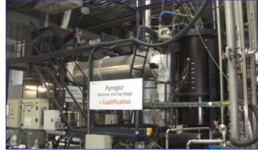
Pilote gazéification étagé 75 KWth
