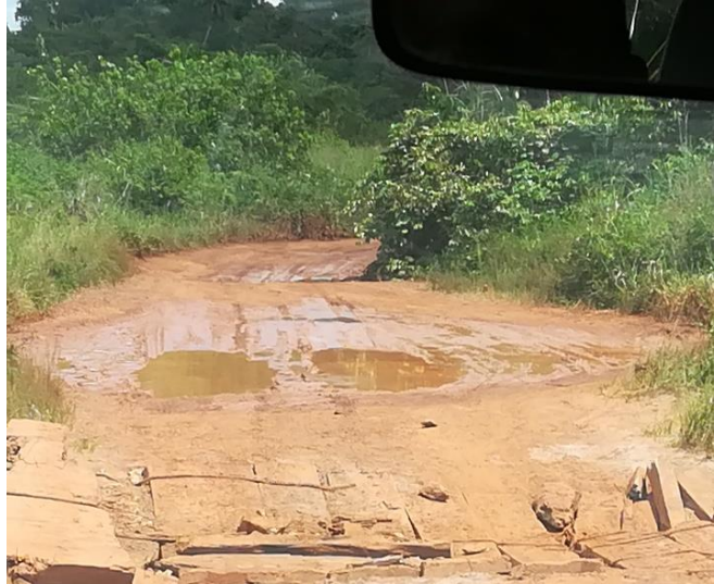
Figure 16: Route d'accès embourbée, pont endommagé en périphérie d'Abenqourou
