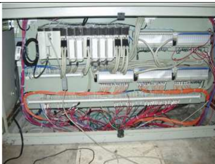
Le câblage général.
